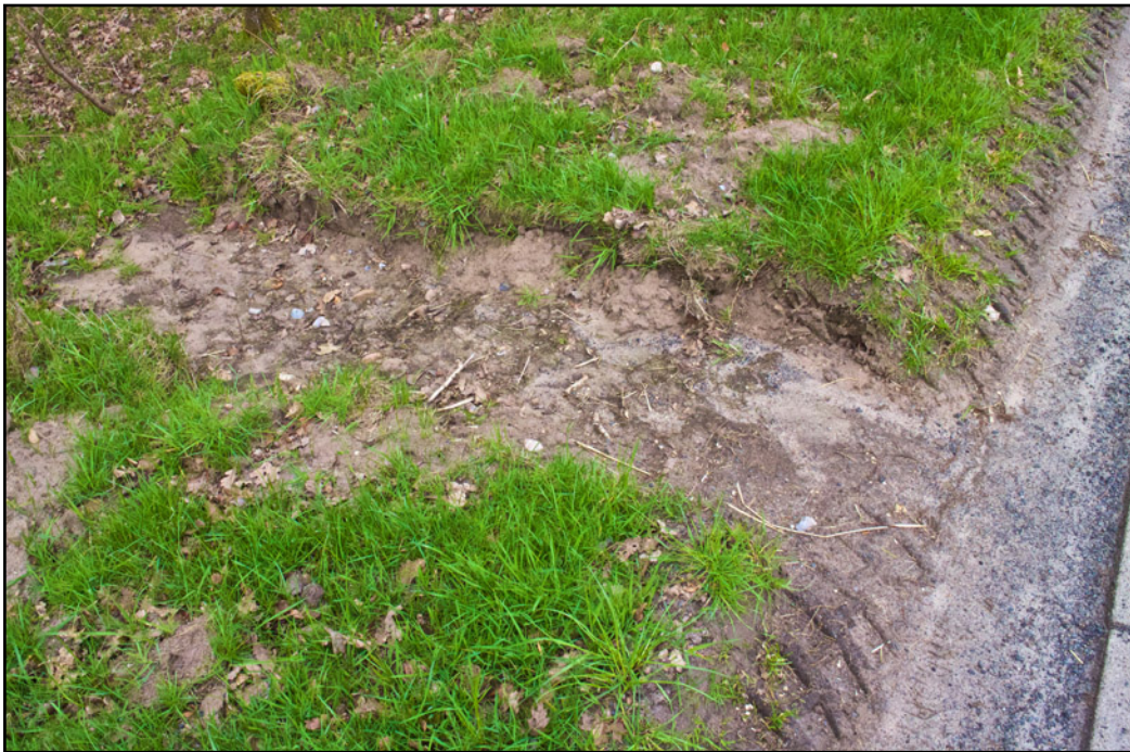
Abb. 21. Abflussrinnen von der Strasse in das NSG
